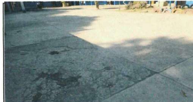
Foto 6: Losa de cancha deportiva con daños.
