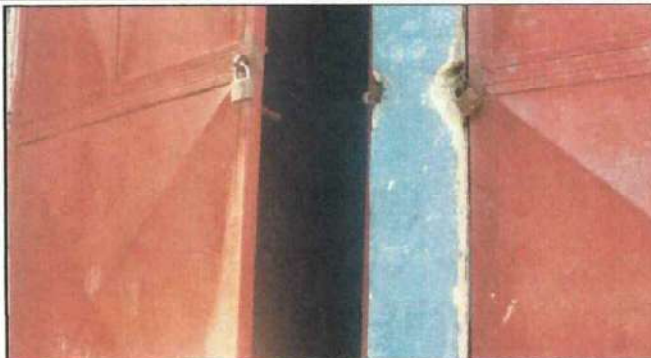
Foto 2: Condición actual de las paredes de los servicios sanitarios.
