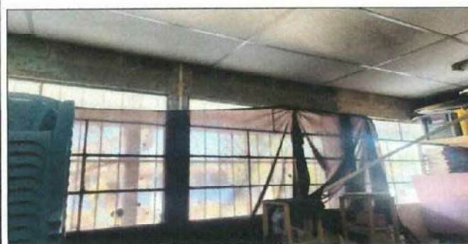
Foto 5: Salon de profesores con paredes dañadas.
