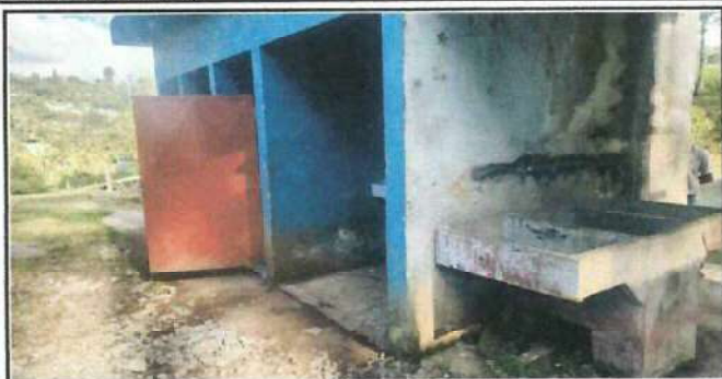
Foto 1: Area de Sanitarios deteriorados y estructura afectados por filtraciones de agua, es necesario resanarlos con azulejos en la parte exterior e interior.
