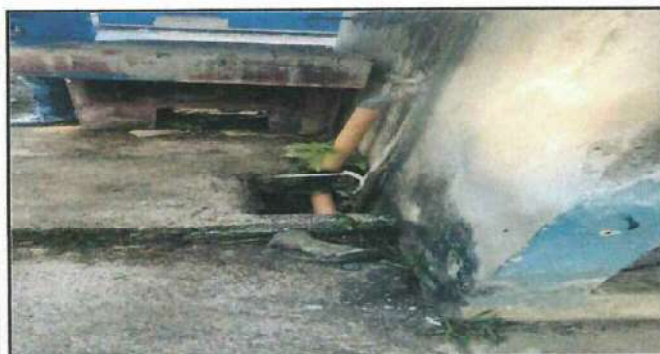
Foto 3: Tubería y paredes de sanitarios con daños por humedad.
