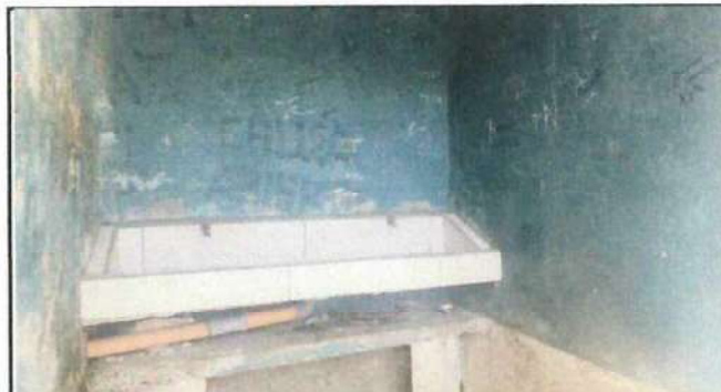
Foto 4: condición actual de paredes y estructura de lavamanos.
